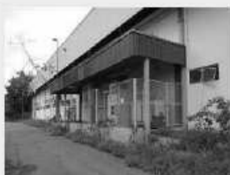
Vista parcial Cabine de Força - Bloco "C"
