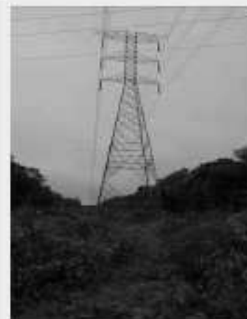
Vista parcial de uma das Torres para Linha de Transmissão que corta a Fazenda Açai
